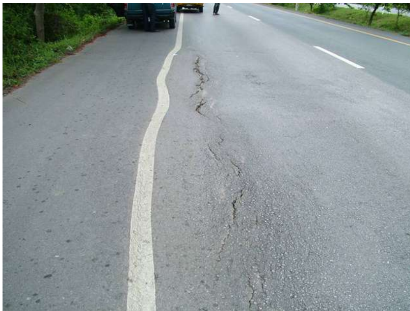
รูปที่ 6.2 รอยแตกจากการเคลื่อนตัวของชั้นผิวทาง (Slippage Cracks)
